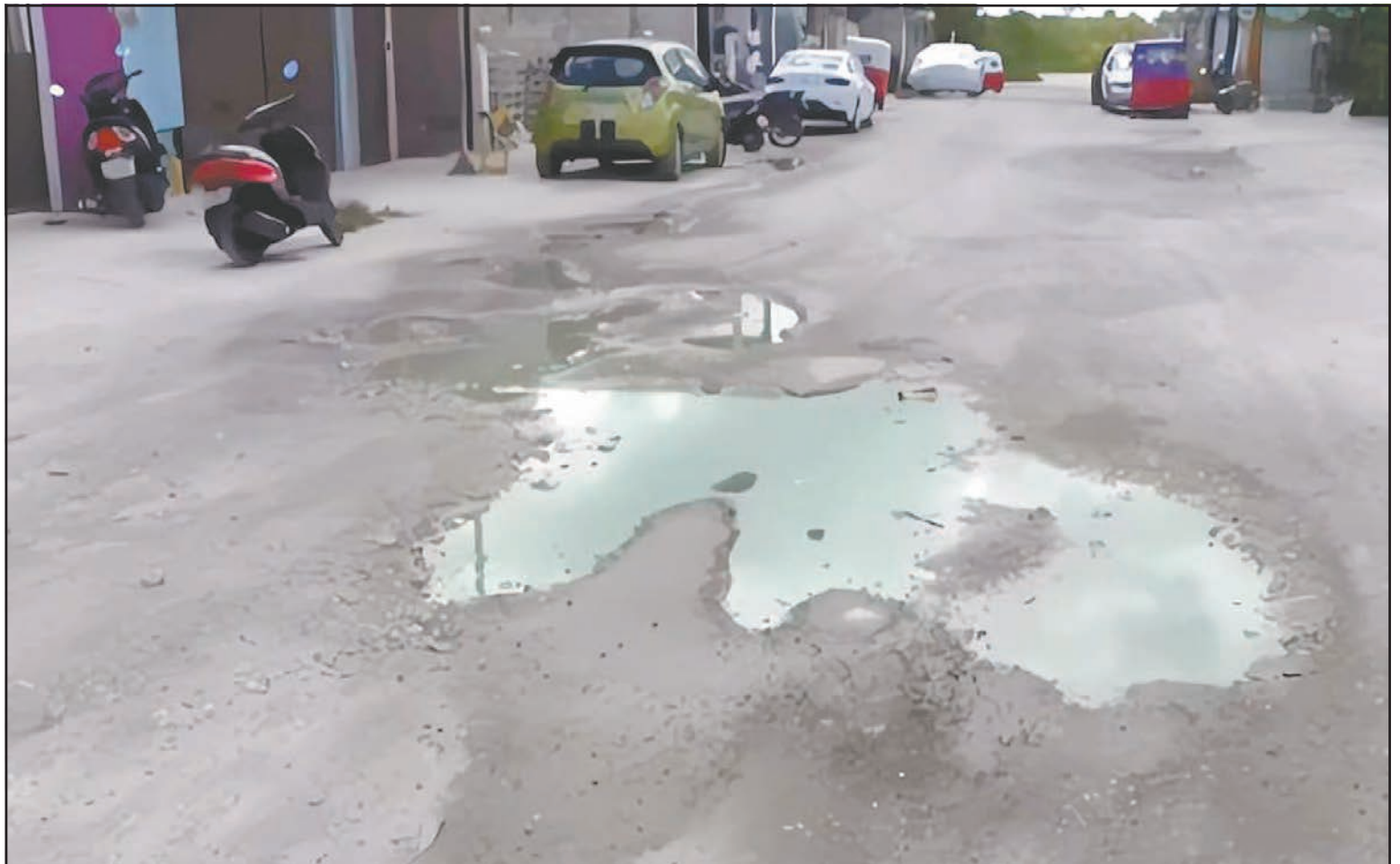
Un funcionario reconoció que el estado actual de las vialidades es crítico, ya que el daño en el asfalto es irreversible. (Antonio Blanco)
