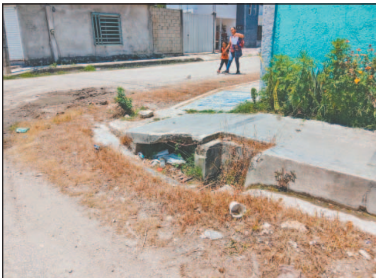
Exigen a Obras Públicas que repare la infraestructura. (Joaquín G.)
