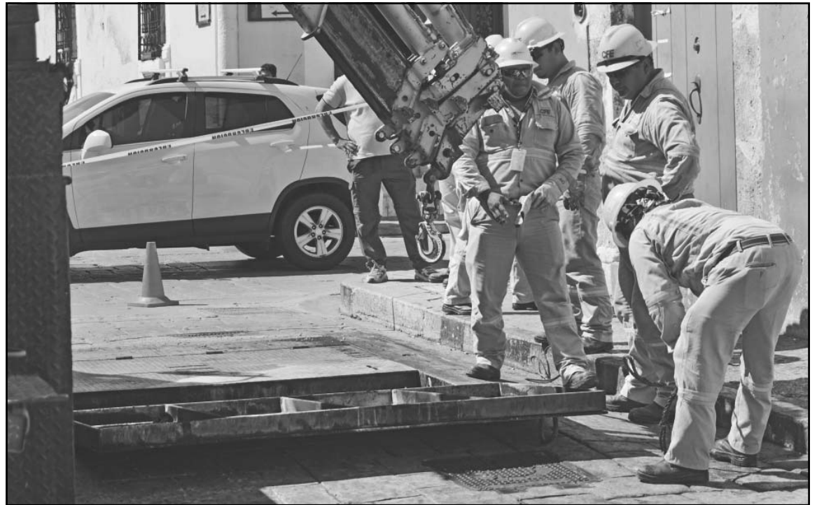
El equipo principal se encuentra en sus bodegas, pero también requieren de cableado. (Lucio Blanco)
