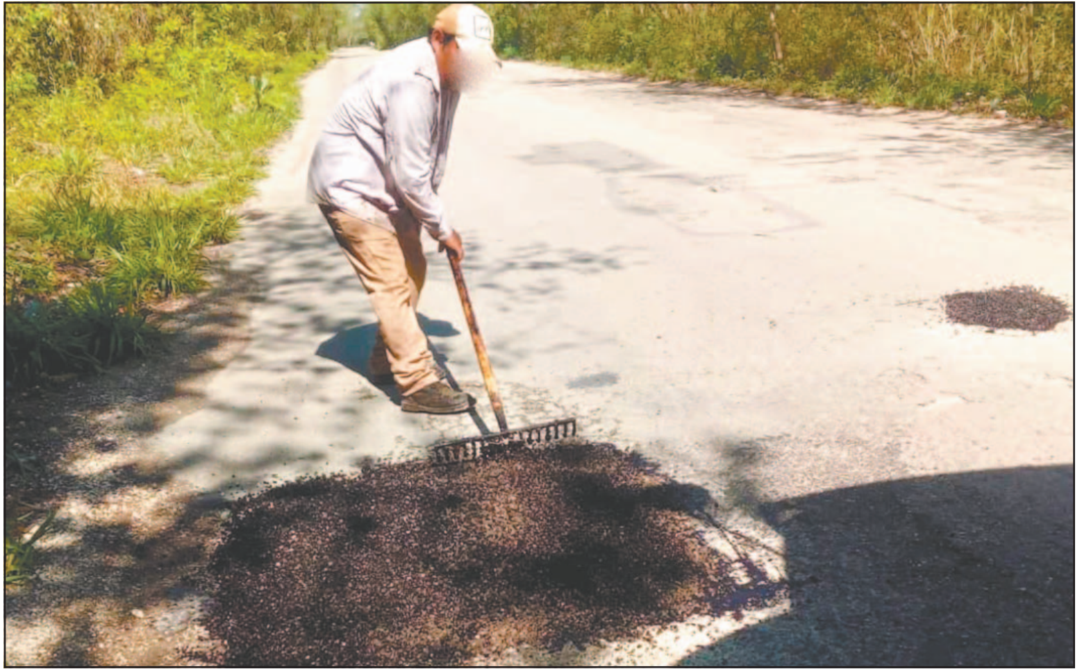
Afectados dijeron que los baches profundos provocaron percances que dejaron daños y en las noches corrían riesgo de accidentarse. (E. Cauch)
