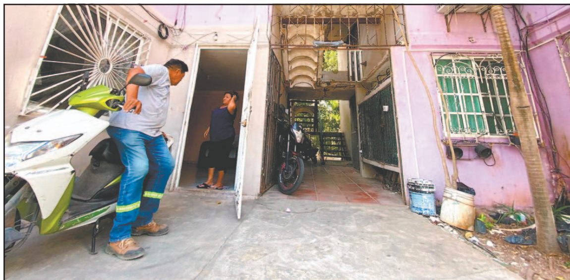
Vecino indicó que les falta realizar una inversión de $100 mil para reconstruir la escalera. (Fotos POR ESTO!)
