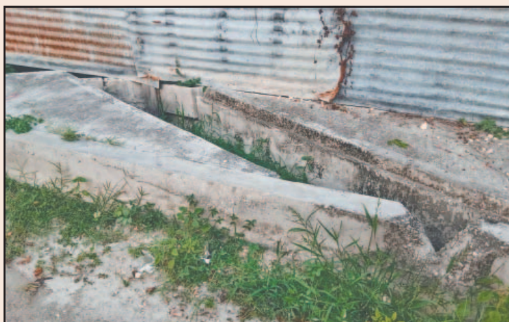
Algunos de los registros no tienen rejilla y la hierba predomina.
