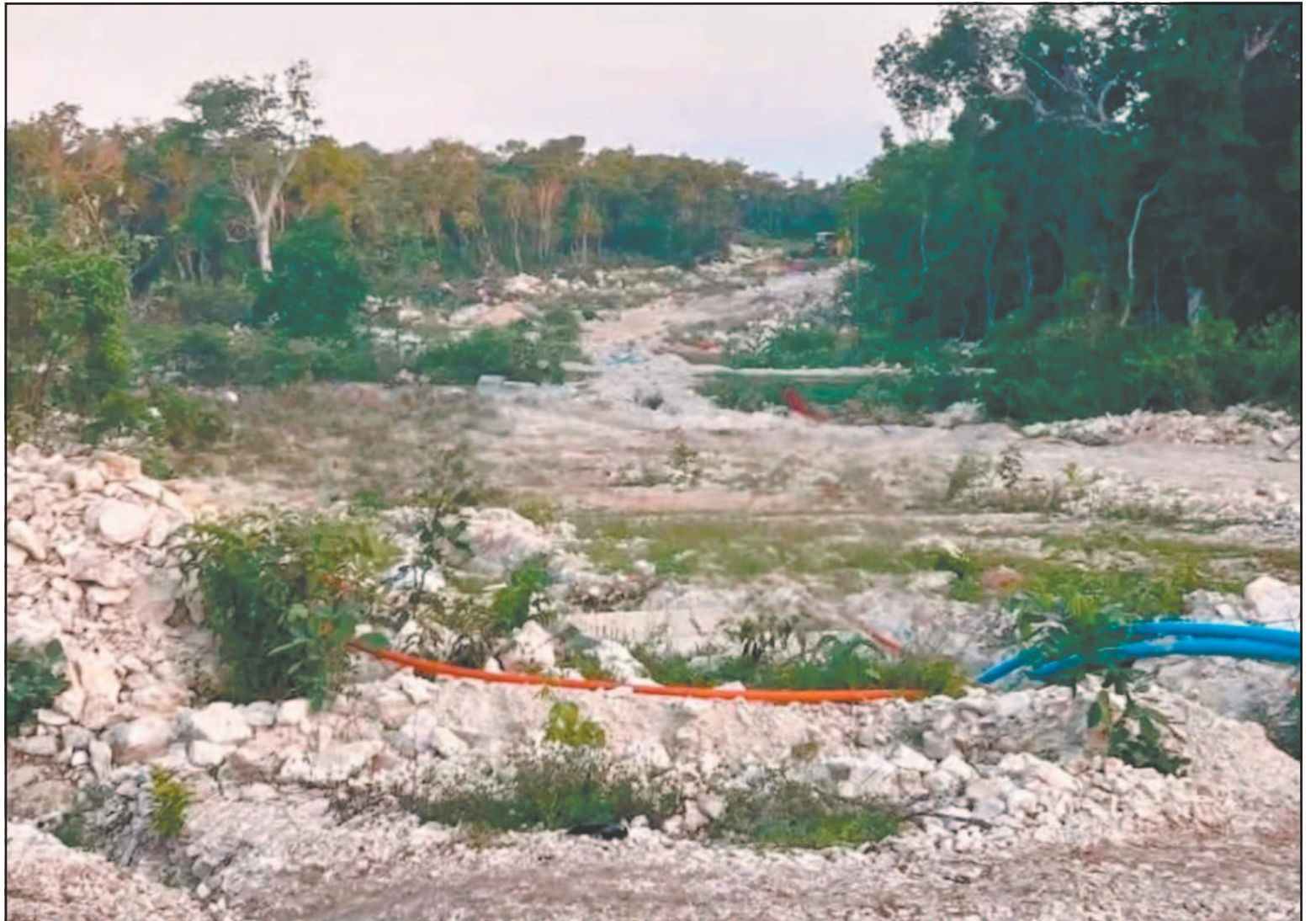
Una inspección evidenció remoción de cobertura vegetal, nivelación del área y acumulación de roca caliza en distintos puntos del lugar.
