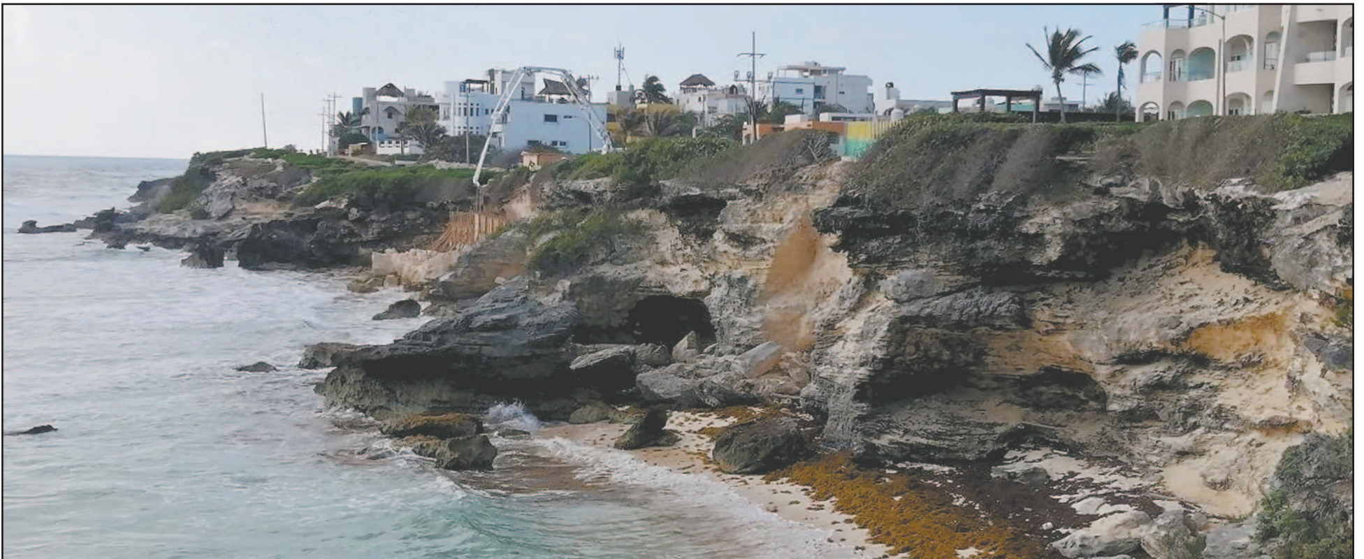
En diciembre pasado se registró el desplome de 30 metros de acantilado, una zona donde predominan cavidades; actualmente llevan a cabo reparaciones. (Ovidio López)
