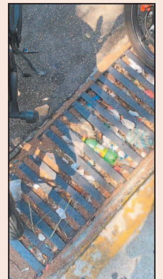
Muchos desagües están tapados por desperdicios.
