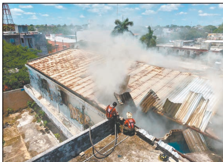
En algunas partes, el techo colapsó y desde ahí dirigieron las mangueras.
