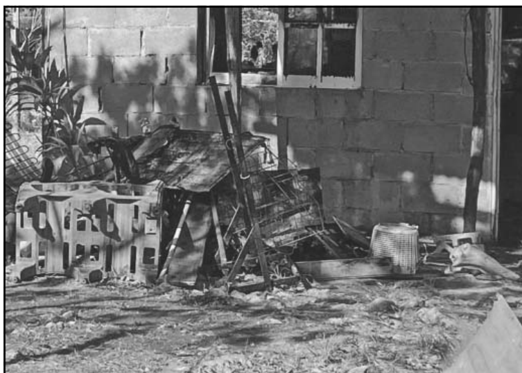
El fuego consumió electrodomésticos y dañó la estructura del inmueble.
