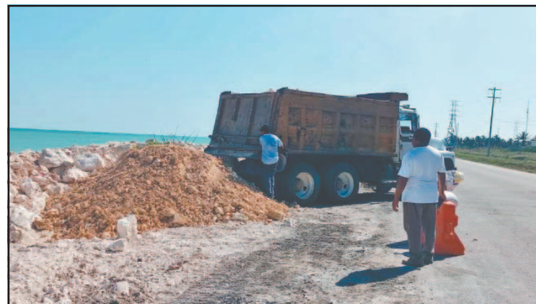
El daño del litoral ha crecido hasta convertirse en un severo riesgo.
