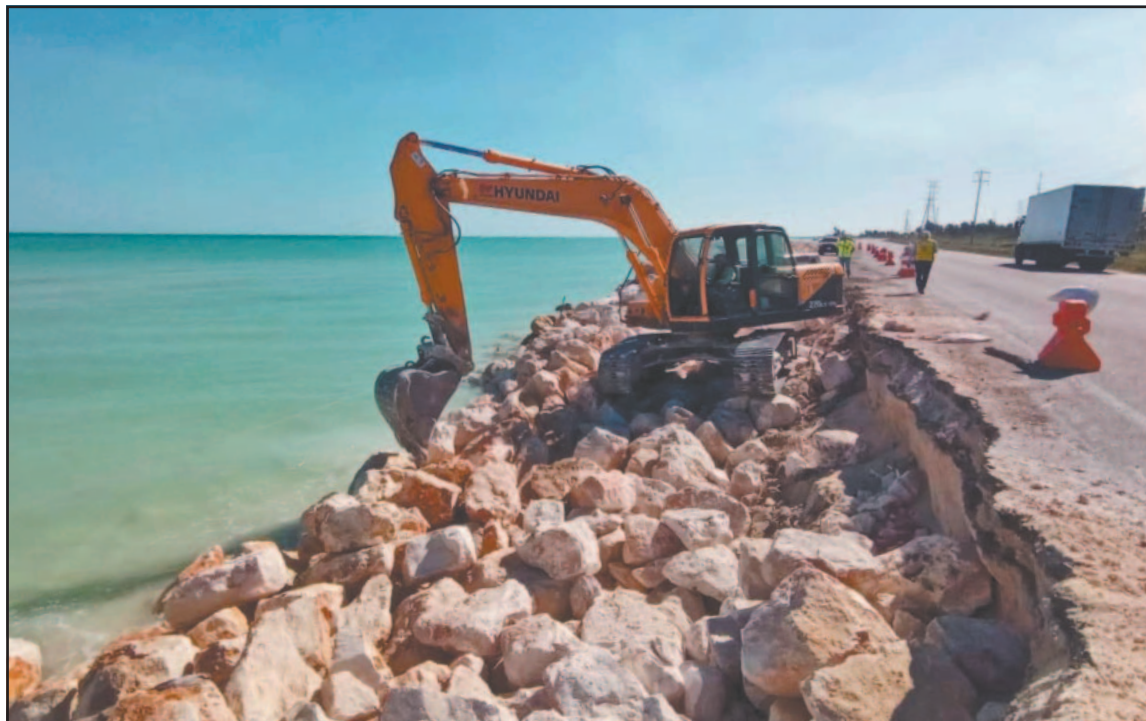
El fuerte deterioro ya había sido reportado por diversos organismos y pobladores locales. (Especial)
