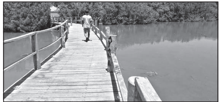
El puente fue vandalizado y representa un riesgo. (Ovidio López)
