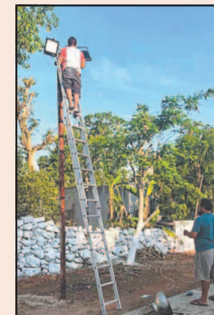
Se cambió la luminaria pública por tecnología LED.
