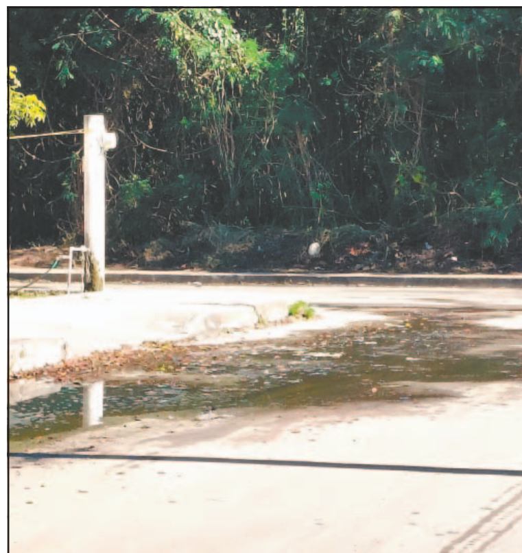
Señalaron que en el pavimento hay agua putrefacta. (F. Baeza)
