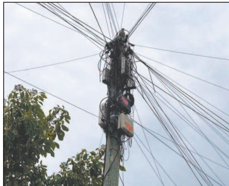
Las líneas eléctricas no respetan la normatividad local. (G. Escalante)
