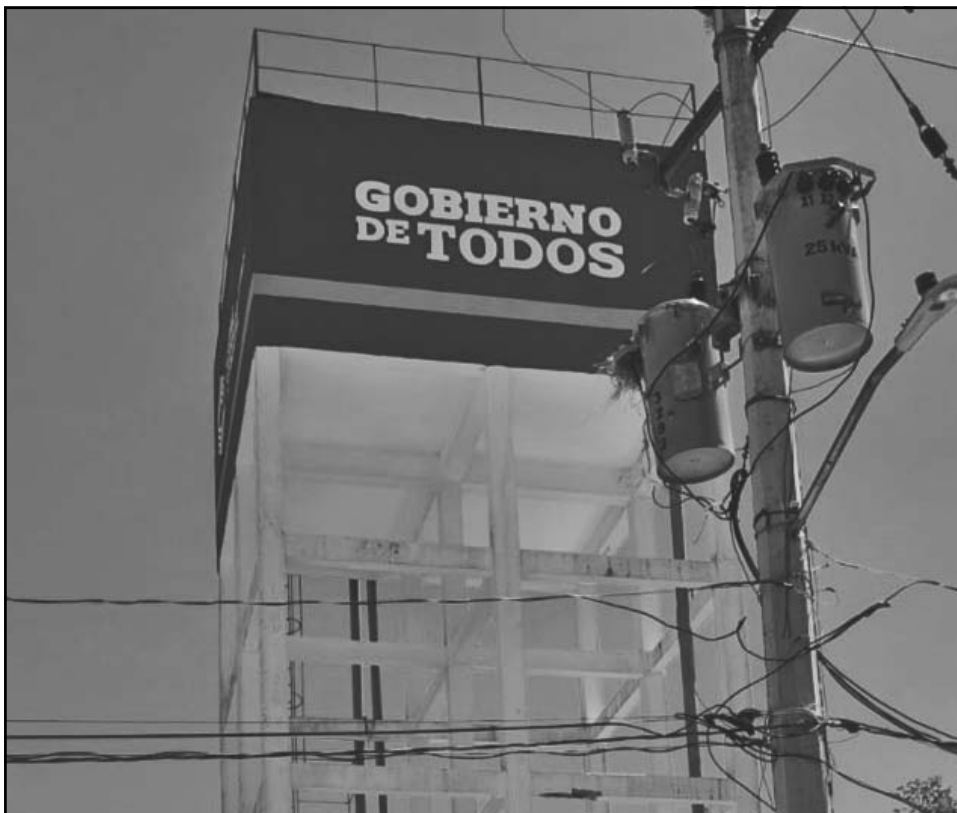
El abrupto corte de energía eléctrica perjudicó el funcionamiento del tanque. (E. Caamal)
