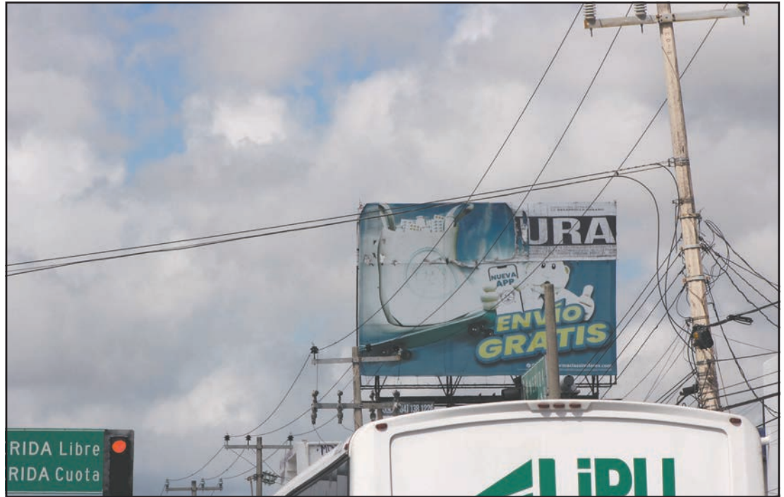
Se observó que las vallas del bulevar Luis Donaldo Colosio no tienen mantenimiento. (Fotos E. Romero)
