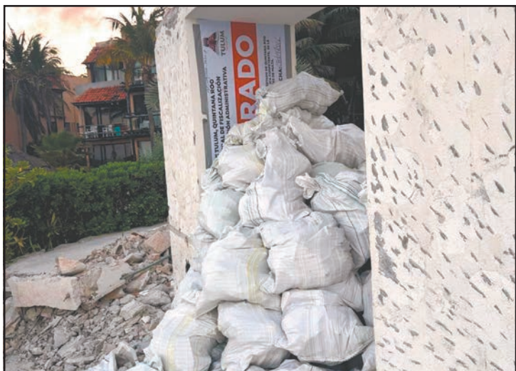
Dijeron que albañiles cubrieron el sello de freno de obra. (POR ESTO!)
