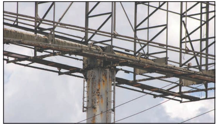
El óxido y la corrosión han dañado las torres publicitarias en el destino.
