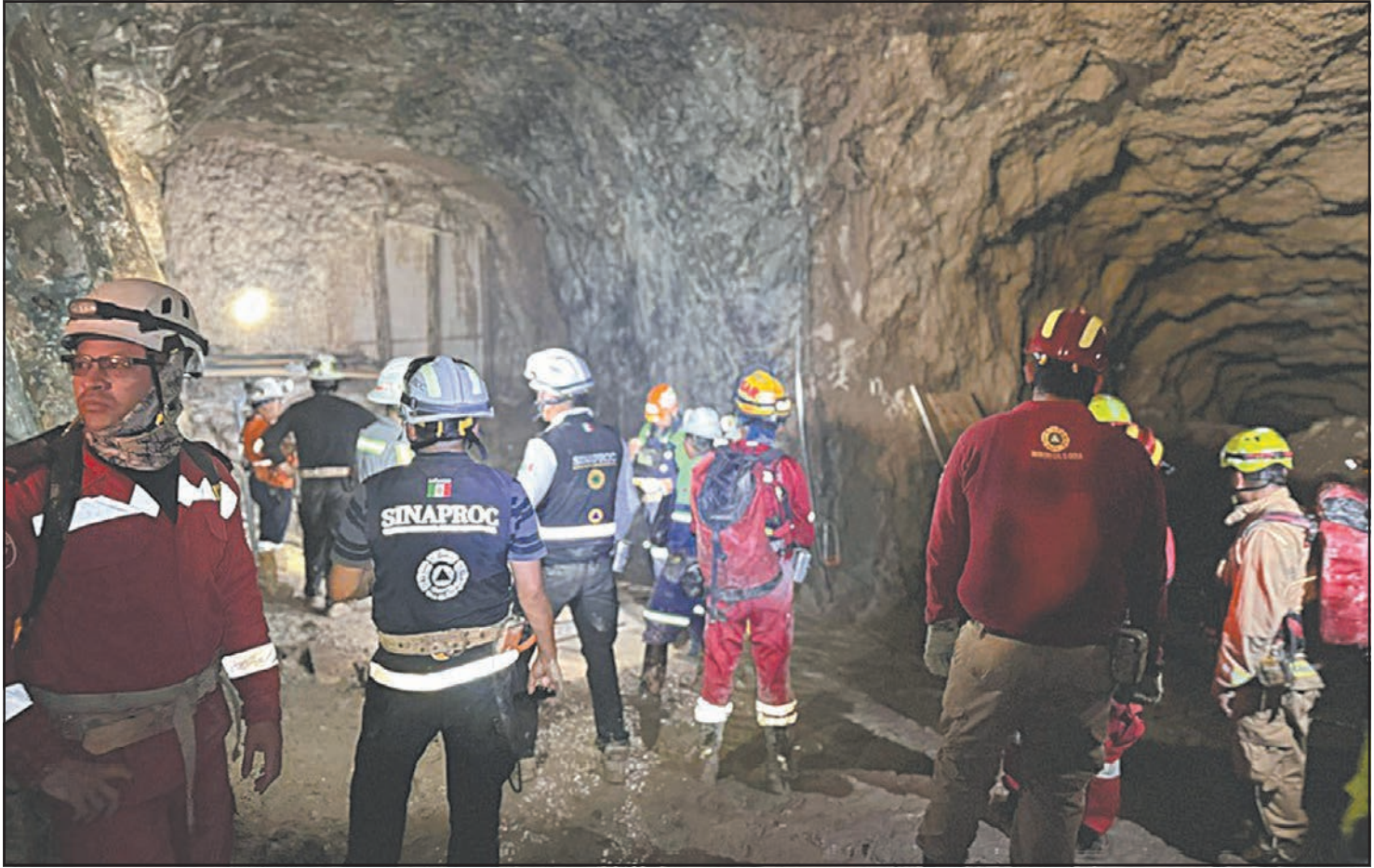
Las autoridades detallaron que persisten las tareas de limpieza de residuos y el sellado mecánico para reforzar la firmeza del terreno. (POR ESTO!)
