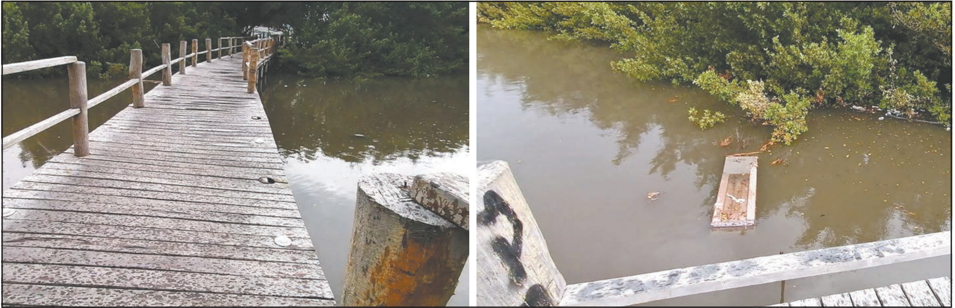
Residentes señalaron que un tramo del paso de madera luce sin barandal, incluso, los pedazos cayeron a la laguna; exigieron vigilancia nocturna en la zona. (Fotos O. López)
