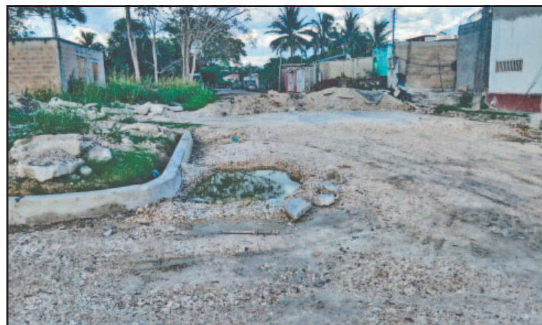
Los trabajos están abandonados desde hace 15 días. (Joaquín G.)
