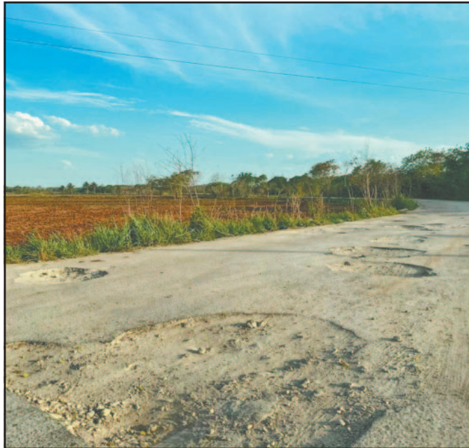
La vía de aproximadamente cuatro kilómetros desde Chencoh presenta numerosos baches en ambos carriles.
