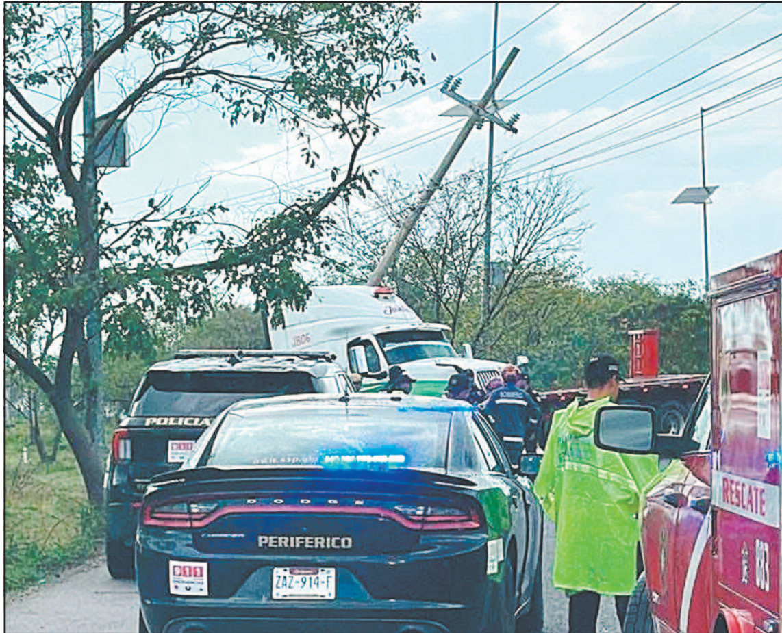
Fue necesaria cambiar la estructura dañada y reinstalar el cableado para poder restablecer el servicio.
