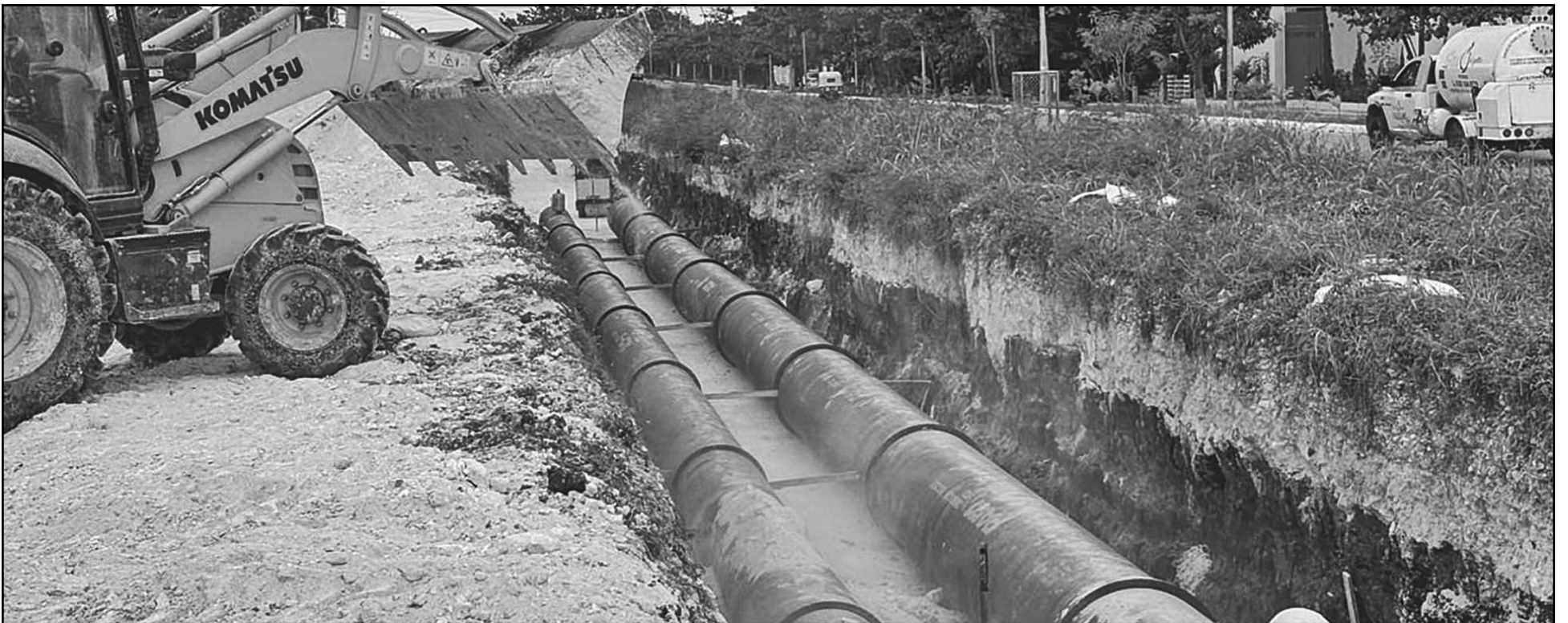
La Federación impulsa en la capital un proyecto que incluye la sustitución de 12.6 km. de línea de conducción y la construcción de 18.5 kilómetros de tuberías. (A. Pech)
