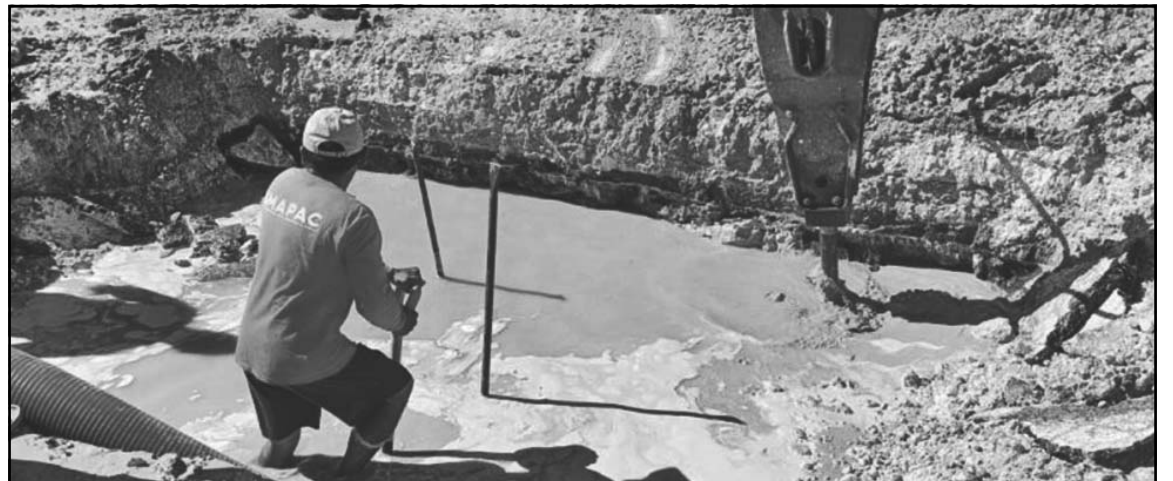
De no atenderse las fugas, el bombeo de agua que se tiene contemplado no funcionaría. (Alejandro P.)
