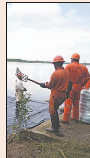
El togado ordenó despliegue para la reparación de daños.
