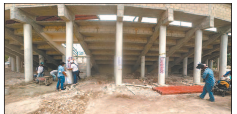
La obra no se concluirá por diversas irregularidades. (Ovidio López)
