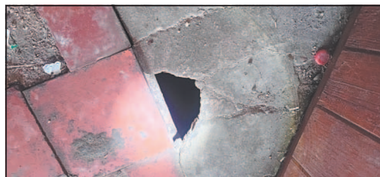
Días atrás la dueña había observado desprendimientos en la losa.
