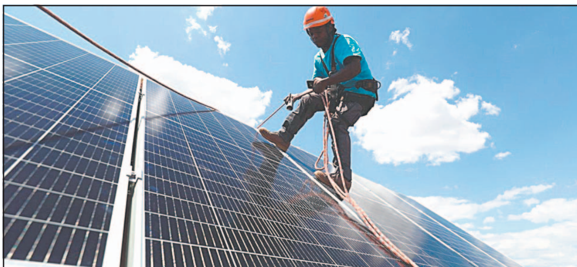
Uno de los proyectos más relevantes es la instalación de una planta vinculada con la energía solar.
