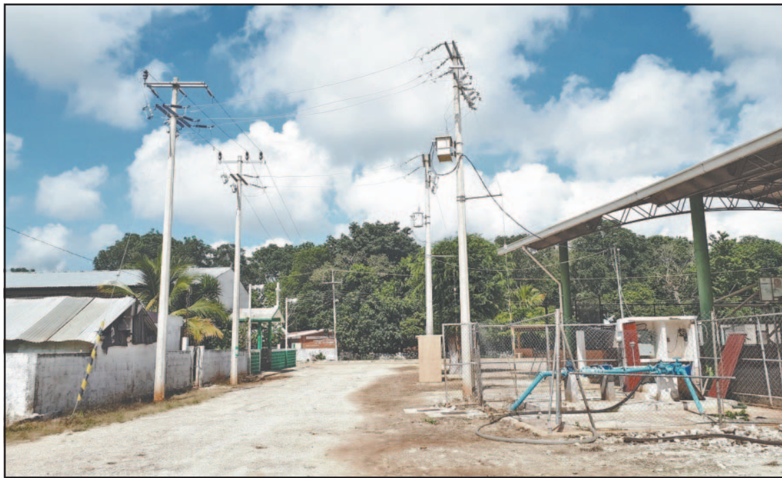
Además de los apagones, el poblado no tuvo agua debido a que las bombas no encienden. (Mauriel K.)
