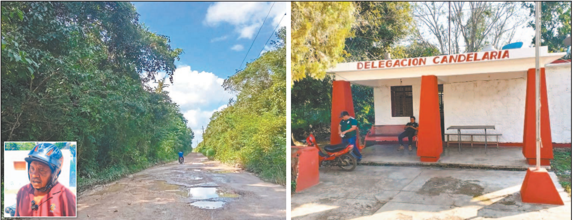
Pedro Pacheco advirtió que la estrechez y deterioro del pavimento obligan a los conductores a esquivar baches, lo que podría ocasionar percances. (Fotos R. Chan / POR ESTO!)
