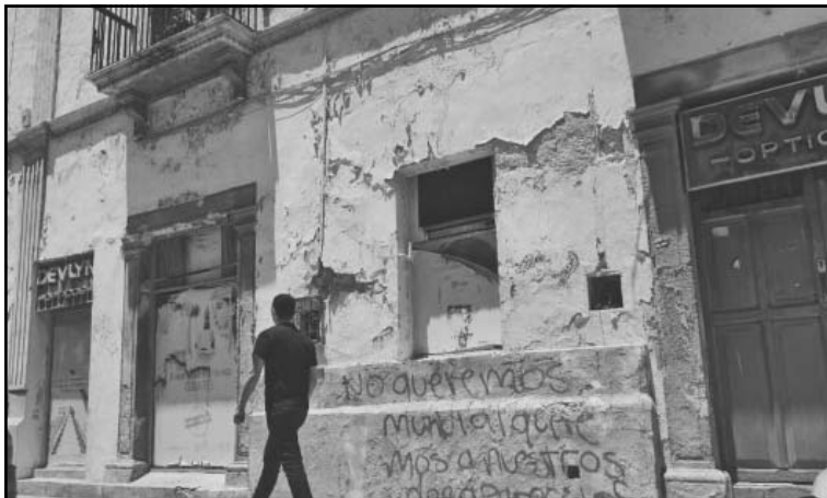
Especialistas advierten deterioro de inmuebles históricos. (A. Pech)
