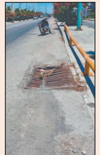
La rejilla no resistirá por el peso de los vehículos.
