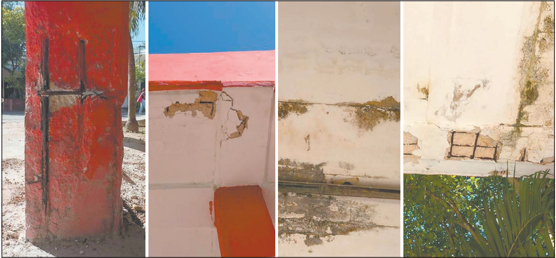
Durante un recorrido se constató que la instalación lleva cerrada años; tiene fisuras en el techo, así como un severo desgastes en las columnas. (Fotos Gustavo Escalante)
