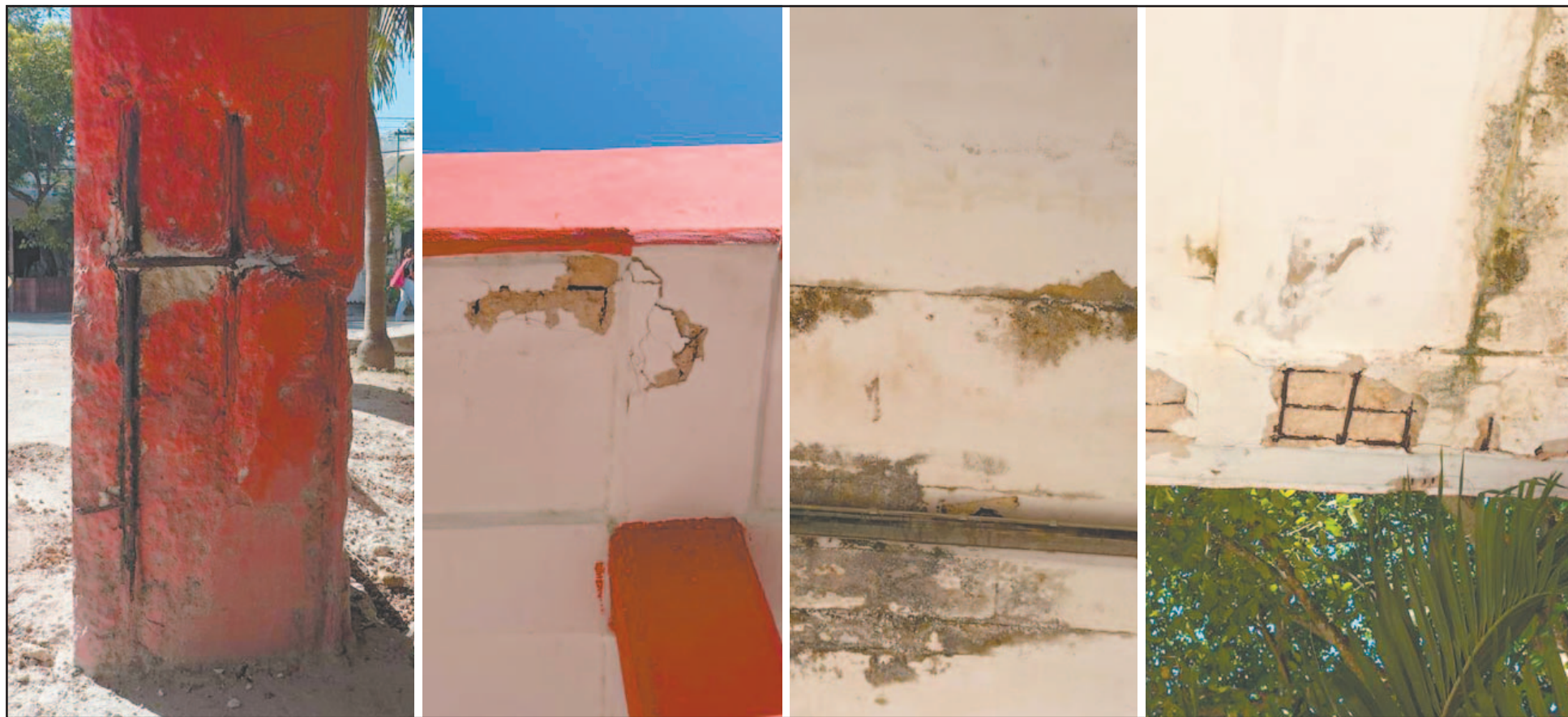
Durante un recorrido se constató que la instalación lleva cerrada años; tiene fisuras en el techo, así como un severo desgastes en las columnas. (Fotos Gustavo Escalante)
