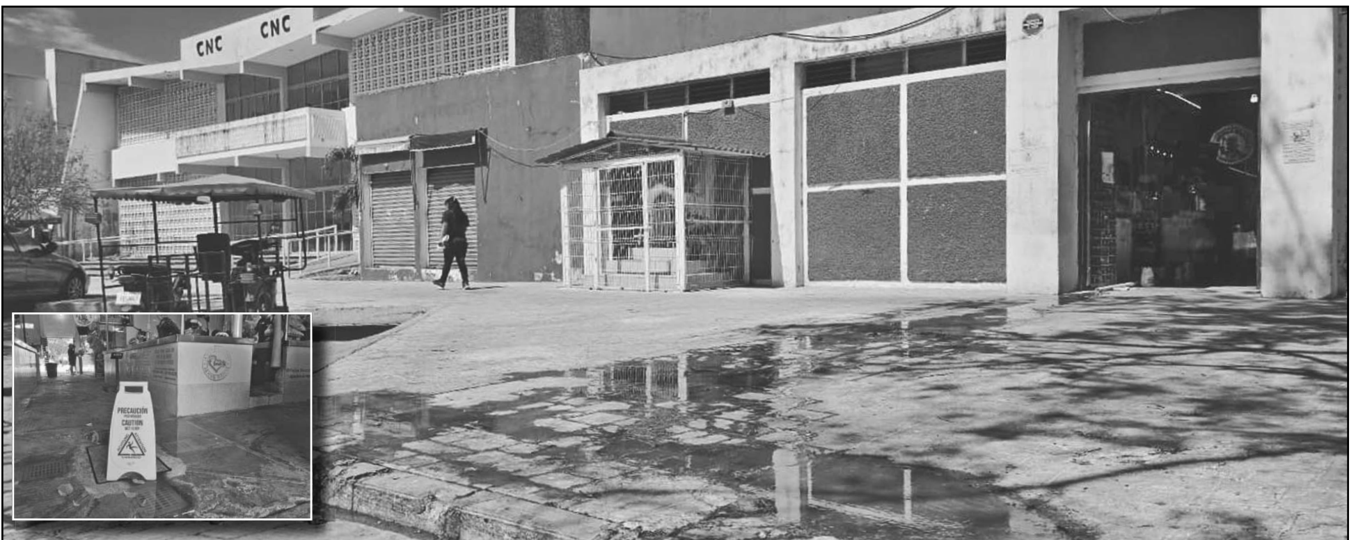
Al entrar al inmueble, lo primero que encuentra la clientela son charcos pestilentes y letreros de piso mojado; la Comuna niega recursos para las reparaciones. (A. Pech)
