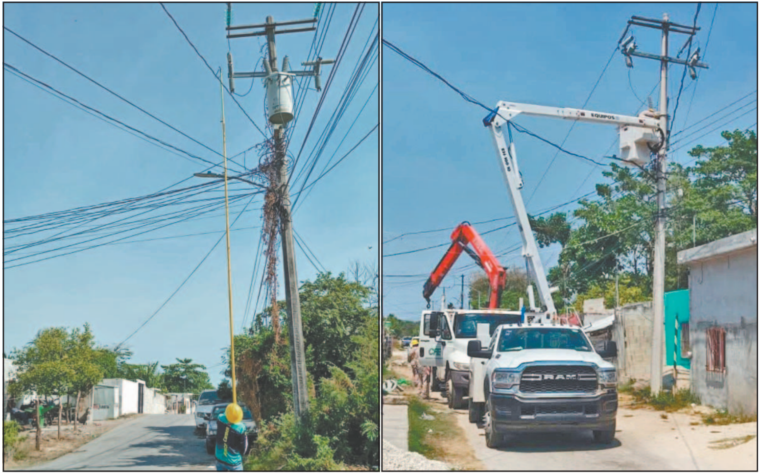
Nuevamente exigieron a la CFE que cambie el tendido y que instale nuevos transformadores para solucionar el problema. (Pedro Díaz)
