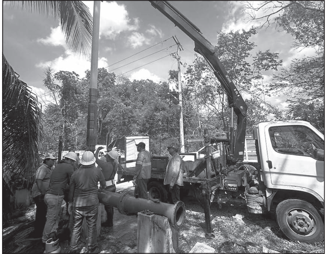
El equipo de bombeo del Pozo 1 mantiene flujo constante en la red de distribución de la ciudad. (J. Xiu)
