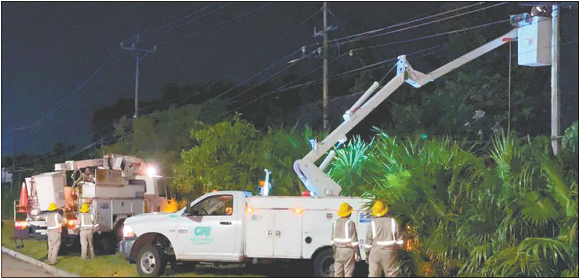
Autoridades municipales pidieron paciencia a los colonos, ya que la luz se va, debido a mantenimiento y modernización que realiza la Comisión durante las noches. (Fernando Olvera)
