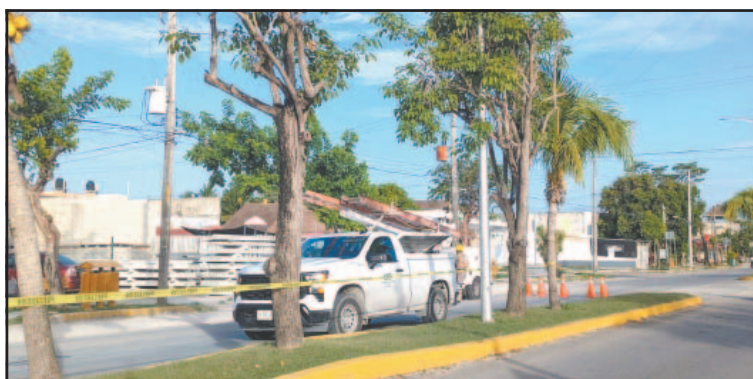
Usuarios advirtieron deficiencias en los transformadores. (A. Blanco)
