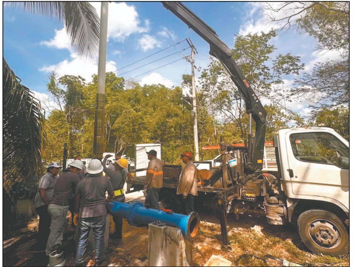
El equipo de bombeo del Pozo 1 mantiene flujo constante en la red de distribución de la ciudad. (J. Xiu)
