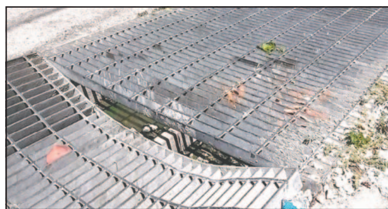
Advirtieron peligro por parrillas de desagüe vencidas. (O. López)
