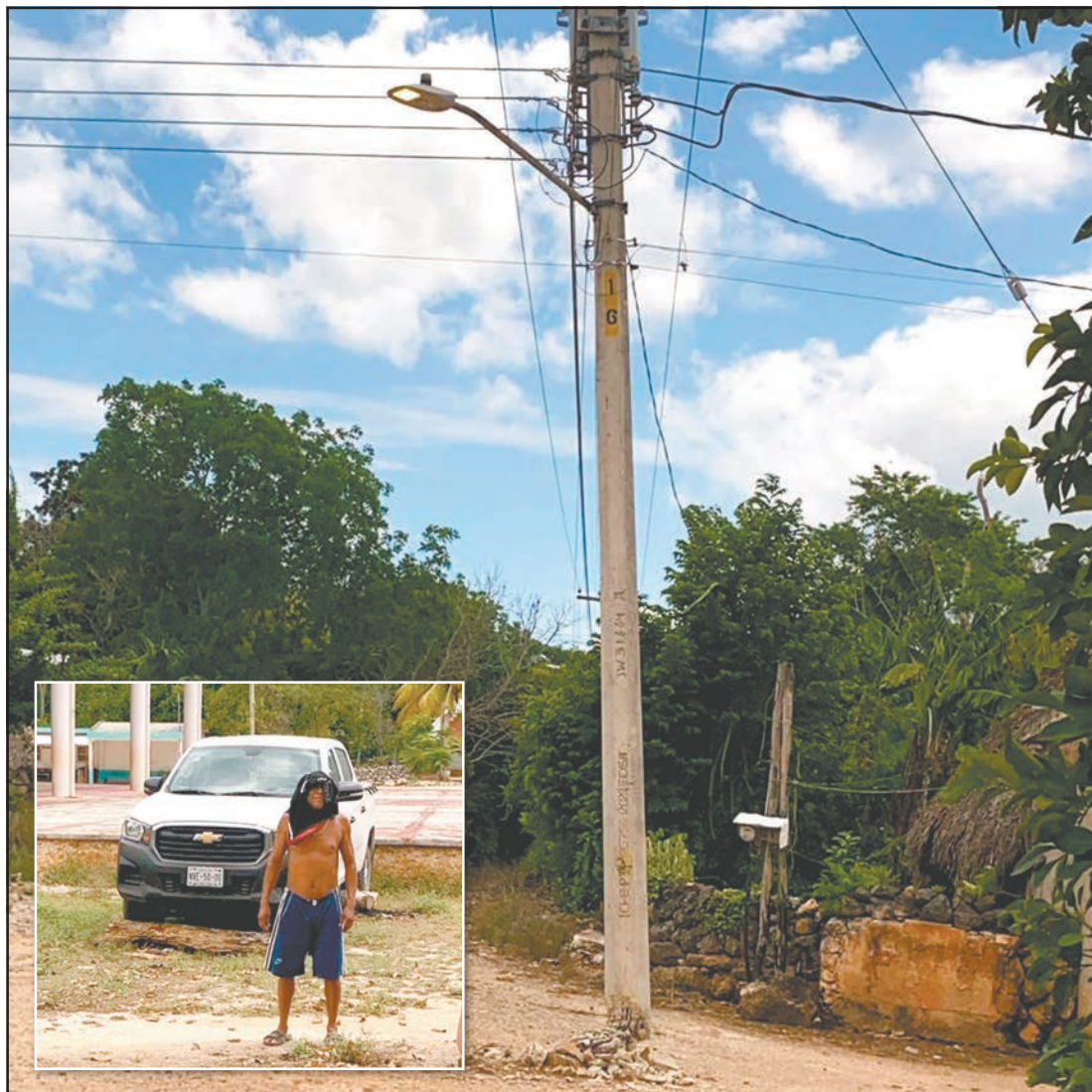
La base de la infraestructura fue dañada por un tráiler y solo es sostenida por los cables. (Justino Xiu)
