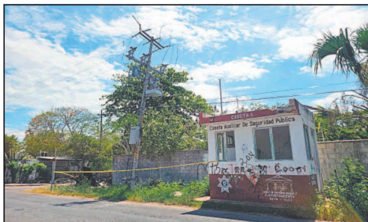
La estructura eléctrica representa un peligro para la ciudadanía.
