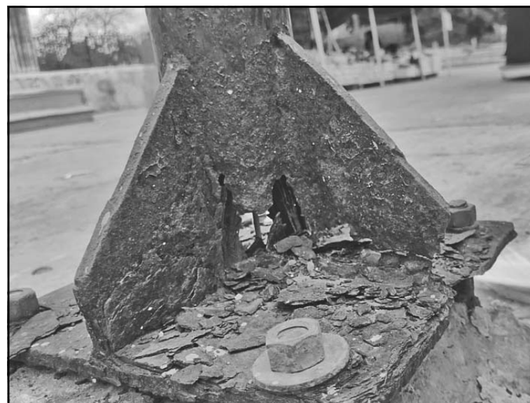
La base de la estructura está a punto de quebrarse. (Erik Caamal)
