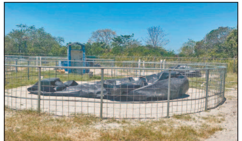
La obra presenta un atraso y faltan por terminar 36 tinas. (Perla P.)
