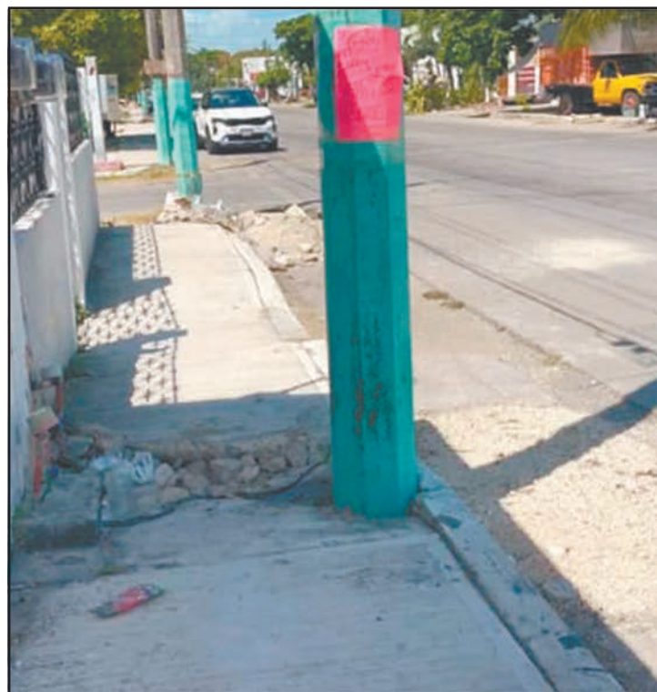
Las lluvias agravaron daños en aceras vecinales. (Fernando Olvera)
