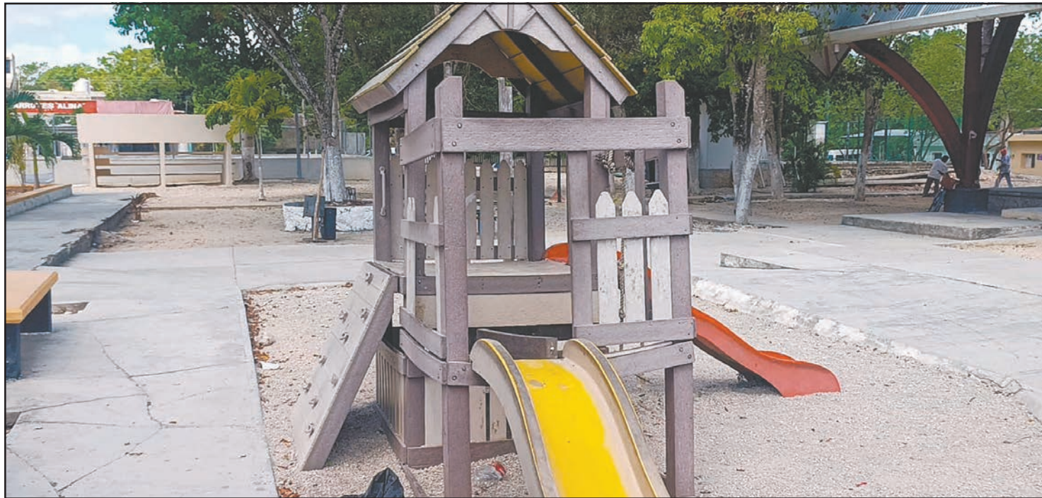
Desde juegos infantiles en mal estado y áreas deterioradas, hasta baños recién rehabilitados cerrados son los principales problemas. (E. Silva)
