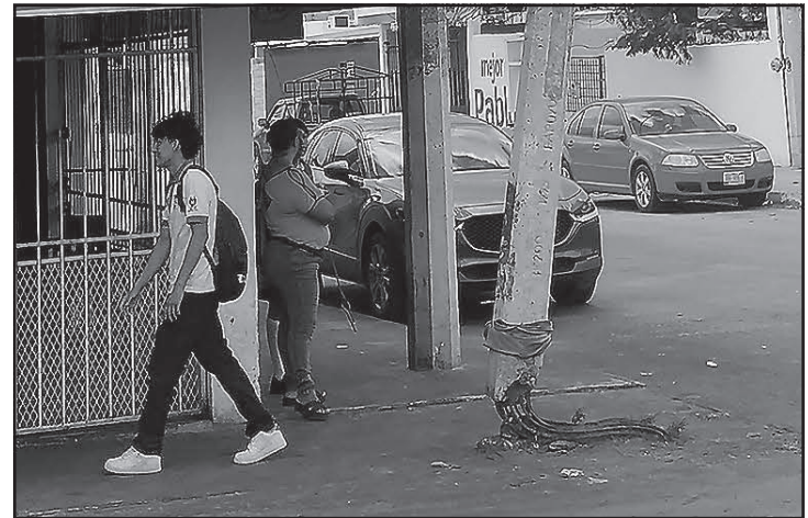
En las calles es común ver estructuras con las varillas de la base dobladas.
