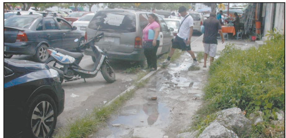
El deterioro de las banquetas genera que transeúntes caminen entre al arroyo vehicular.
