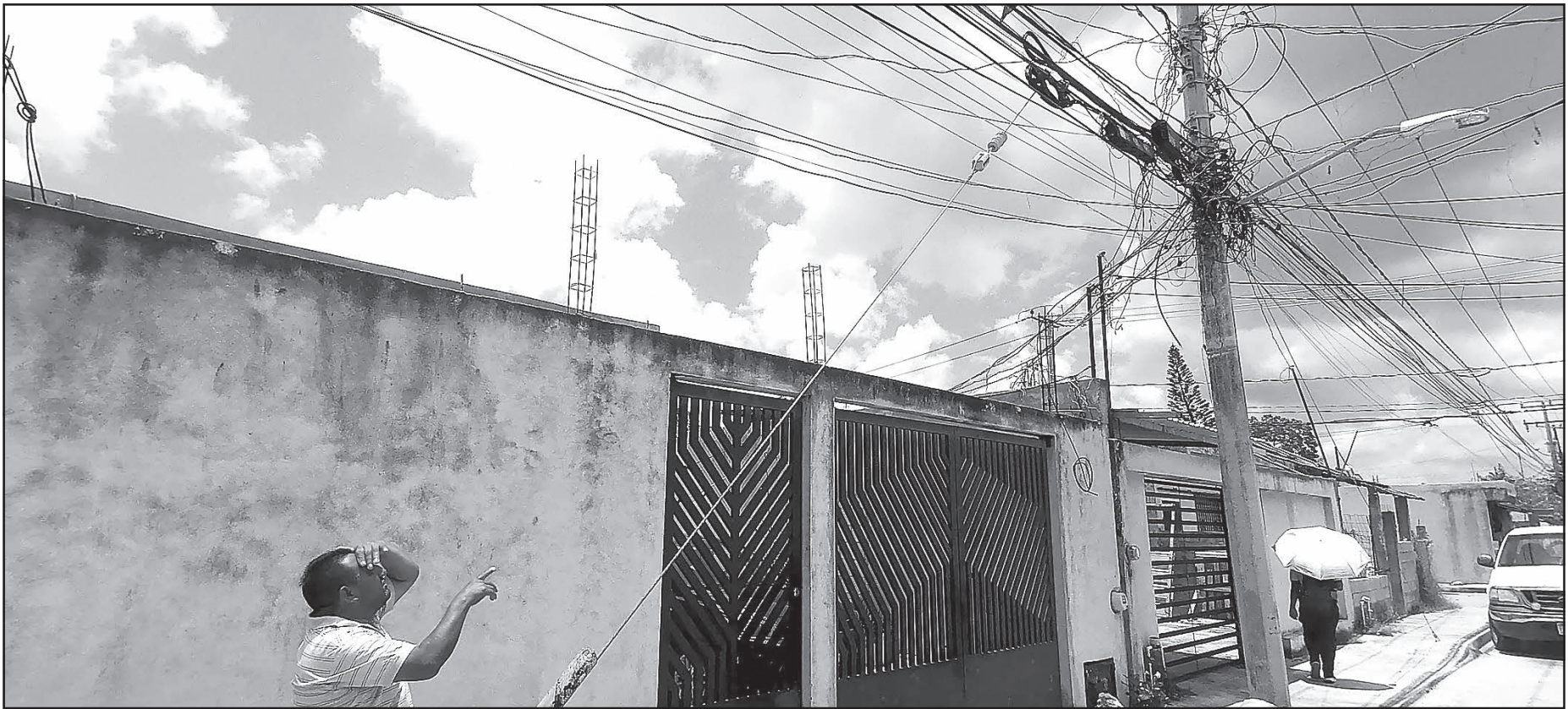
Ciudadanos denunciaron el mal estado en que se encuentran numerosos postes, los cuales están sostenidos únicamente por una maraña de cables enredados. (Fotos Erick Romero)
