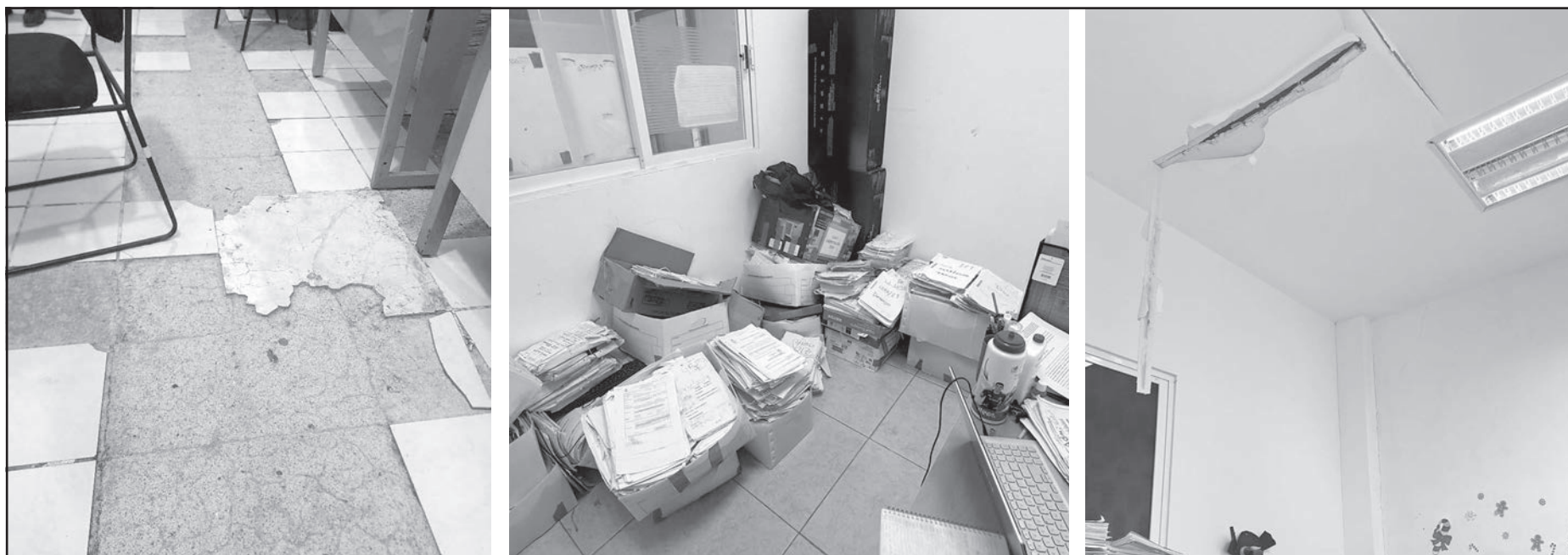
Entre las irregularidades que fueron acusadas están sanitarios fuera de servicio, expedientes almacenadas en el suelo, techos deteriorados y aires acondicionados sin servir. (F. Olvera)
