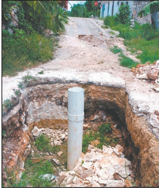
Ciudadanos dijeron que podría ocurrir algún accidente en los hoyancos que están abiertos. (Fotos J. Xiu)
