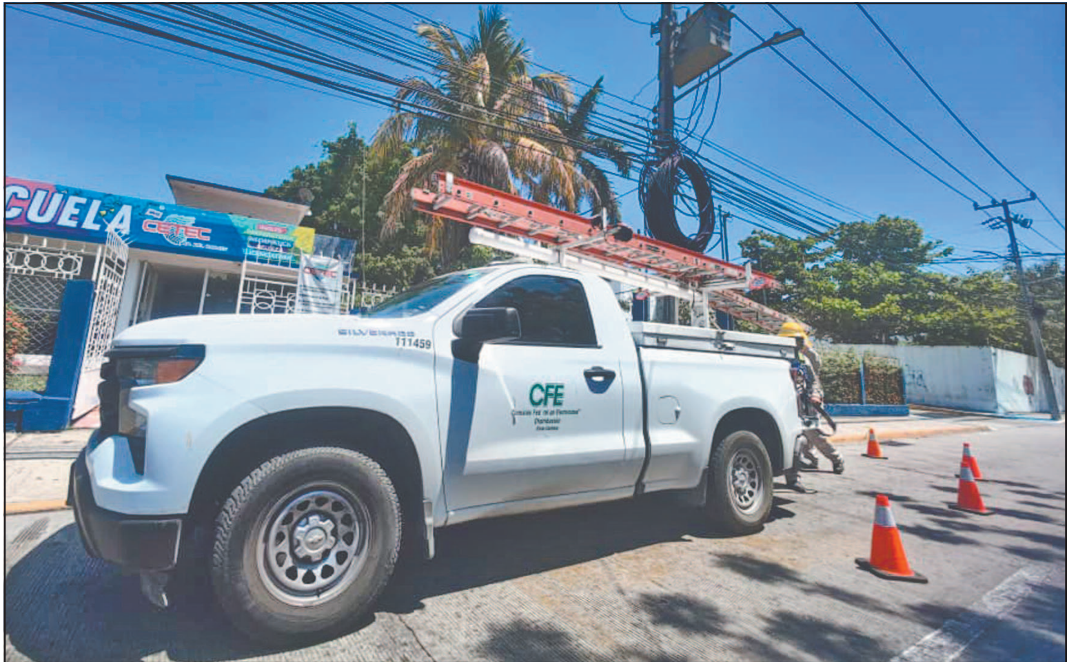
Trabajadores de la empresa dicen que no cuenta con herramientas, materiales o equipo suficiente para atender las fallas. (Perla Prado G.)
