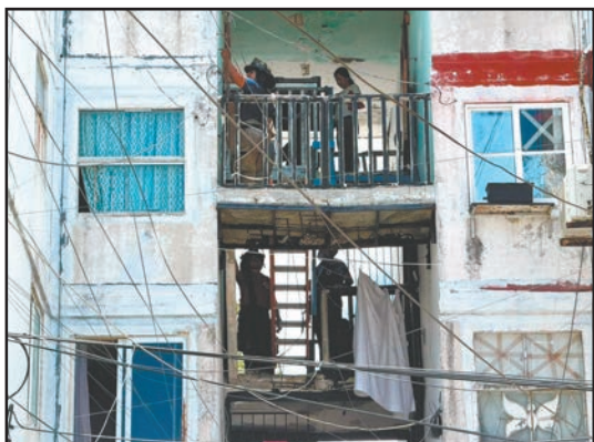
VECINOS del último nivel fueron evacuados con apoyo de bomberos ante el riesgo de otro desplome en el edificio habitacional.- (L. Chacón)
