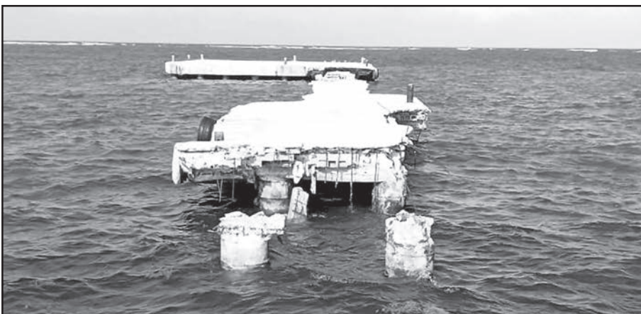
La Secretaría de Obras Públicas Estales se comprometió a la reparación de un tramo.
