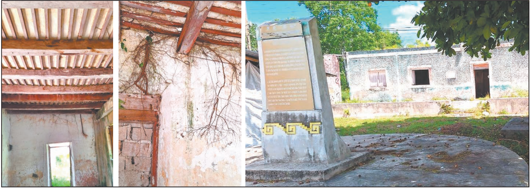
Las instalaciones se le prestaron al Telebachillerato, pero el techo empezó a caer y se desaljó. Habitantes dijeron que este debería rehabilitarse para evitar su colapso. (Fotos L. Kauil)
