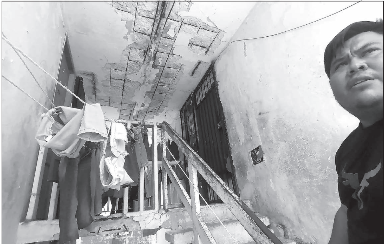
El desplome de una parte de la estructura motivó a que los residentes se organizaran para que un herrero cotice los trabajos. (Fotos E. Romero)
