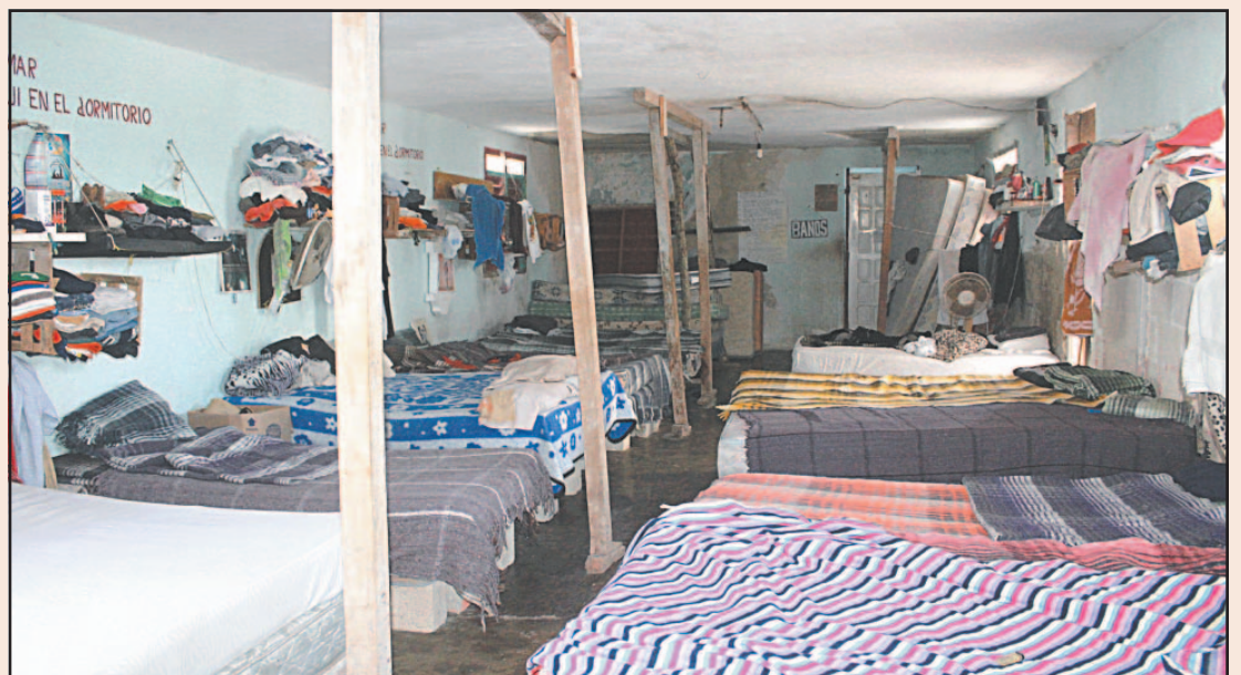
El techo del dormitorio ha sido apuntalado para resistir, aunque hay riesgo de que se derrumbe.
