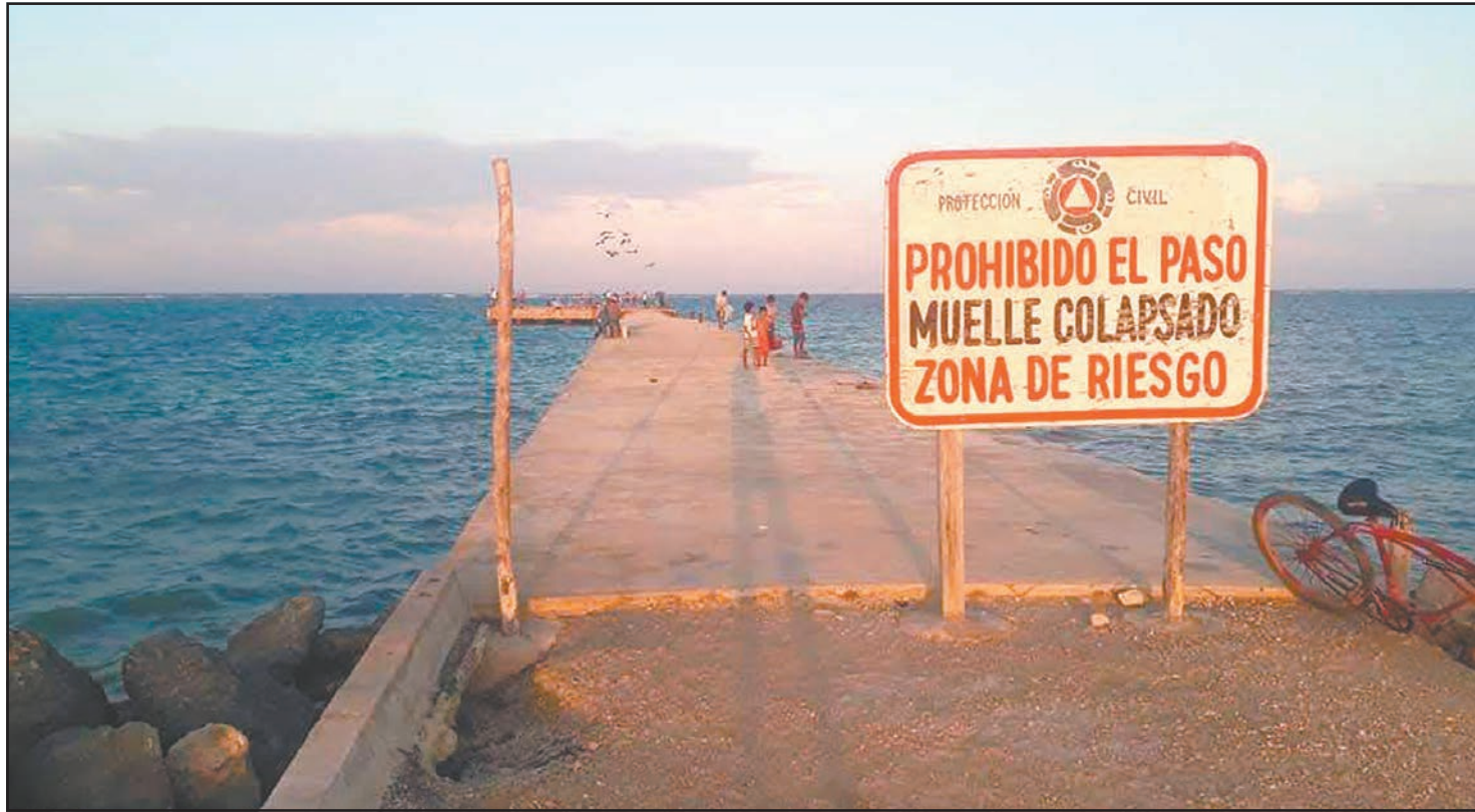
Las cooperativas preparan un oficio formal ante la SICT para frenar el colapso de 40 metros de la estructura. (Fernando Olvera)
