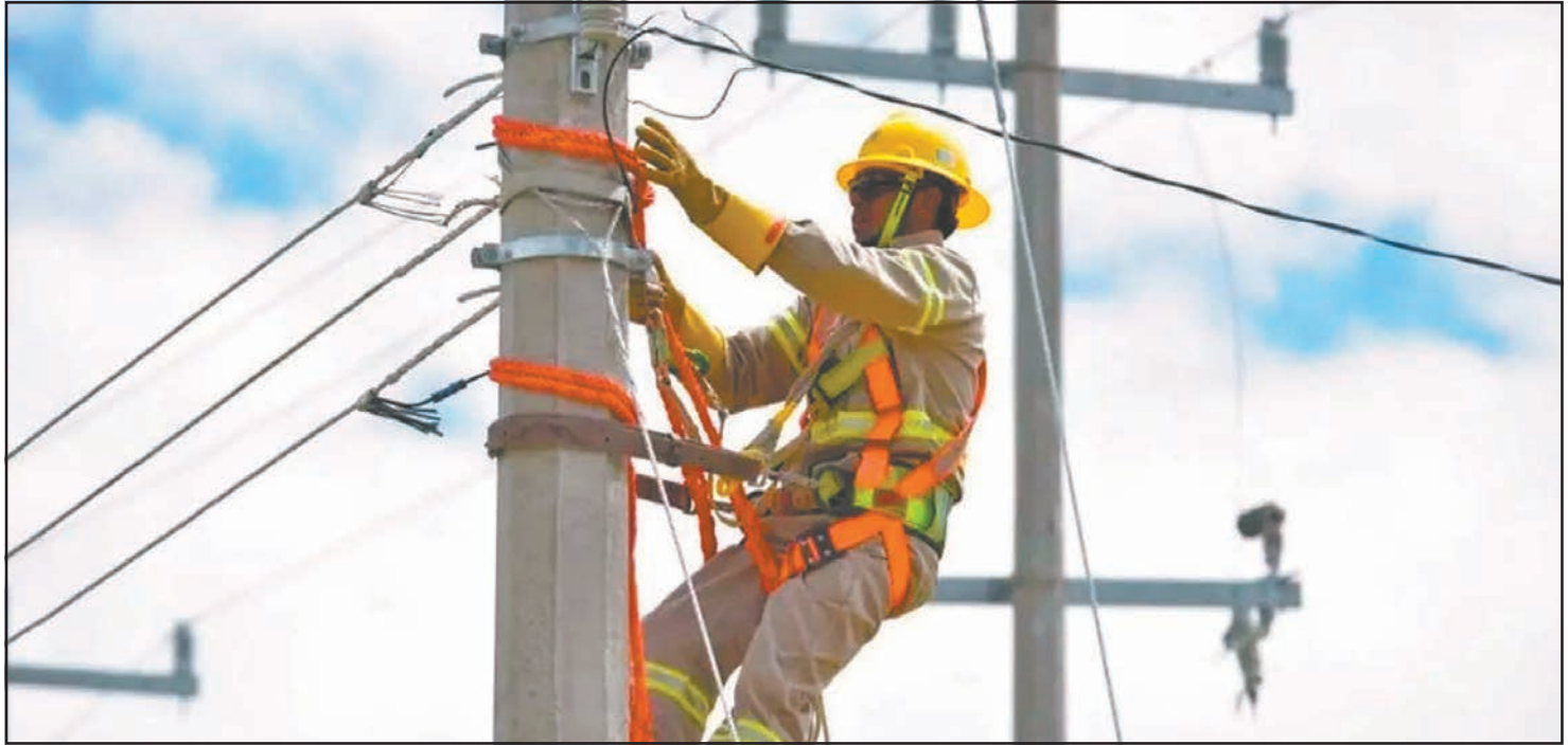
Los desperfectos han sido por las sobrecargas en temporada de calor, de acuerdo con los trabajadores de la paraestatal. (Fernando Olvera)
