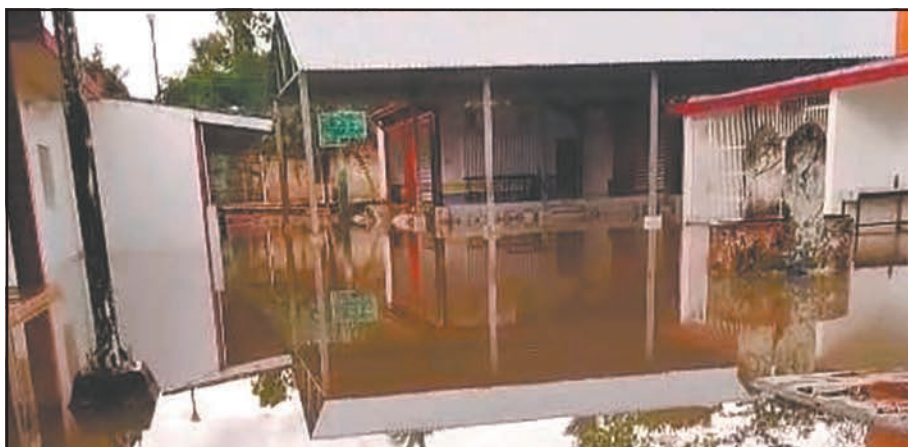
La falta de mantenimiento a pozos pluviales generó que una primaria se inundara.
