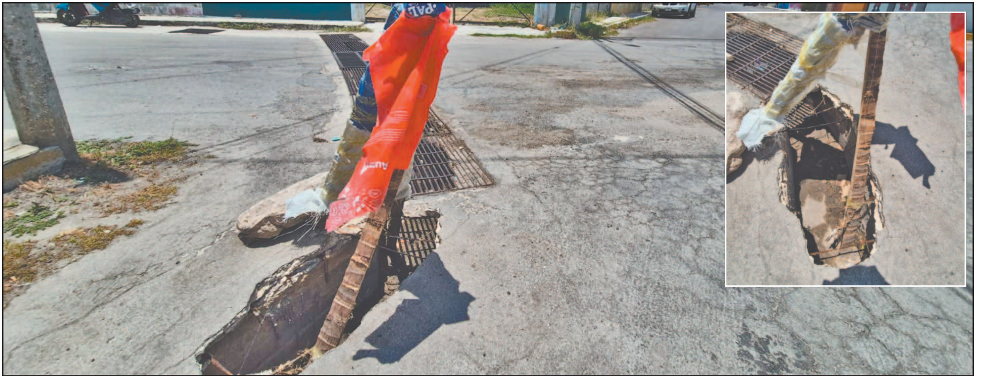
El problema inició como un hundimiento pequeño; el daño corresponde a un tramo de carpeta asfáltica colapsada sobre una línea de drenaje pluvial; las lluvias han agravado el problema.
