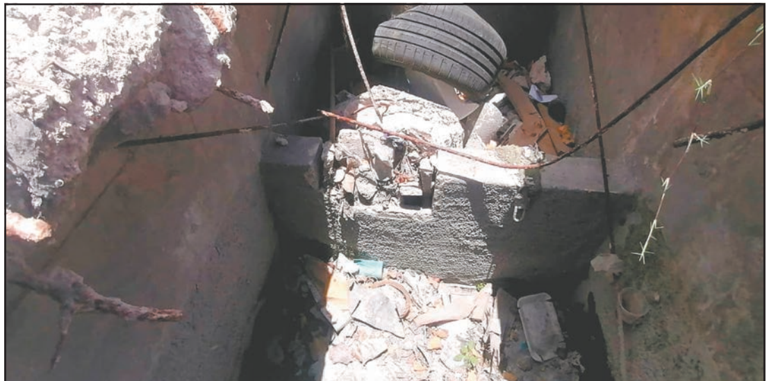
Quejosos llamaron a Obras Públicas a reparar la oquedad ubicada en las calles 25 y 46. (Fotos E. Romero)
