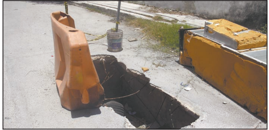
Las malas condiciones de la tapa de la alcantarilla generaron que cediera y se hundiera.
