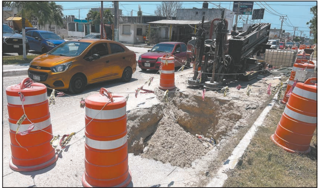
Desde hace un mes, los trabajos del cableado pararon en la zona, afirmaron afectados. (Fotos E. Martín)
