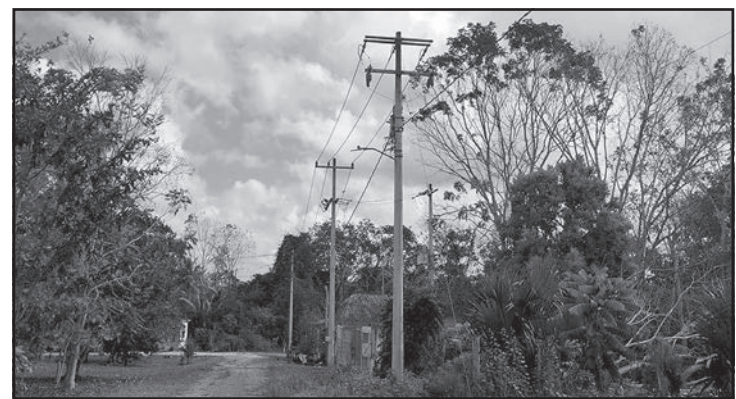
Al parecer, las fallas son por deterioro en los cables. (Lusio Kauil)
