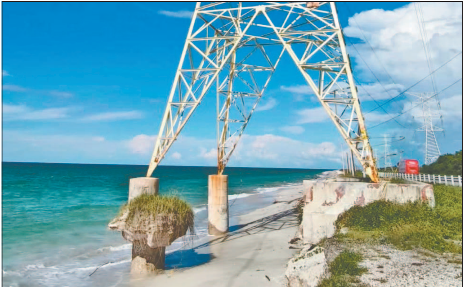
De no atender de inmediato este problema podría haber graves consecuencias por cortes de electricidad y comunicación. (POR ESTO!)
