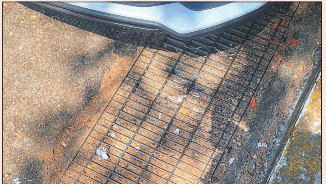
La basura, tanto de vegetación como la arrojada por la gente, causa bloqueos en rejillas pluviales.
