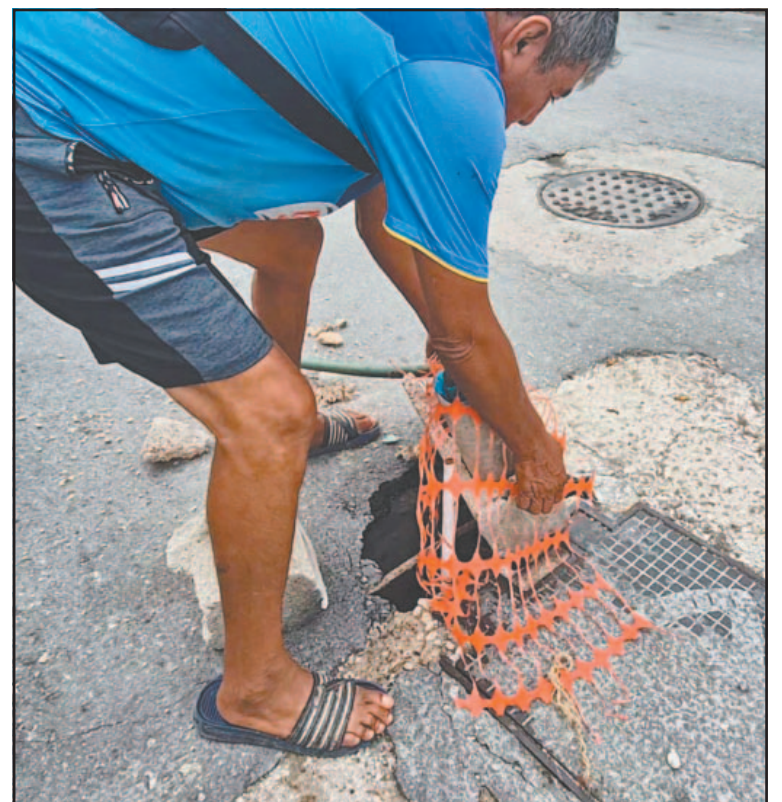
Culpan del problema a la mala calidad de los materiales utilizados.
